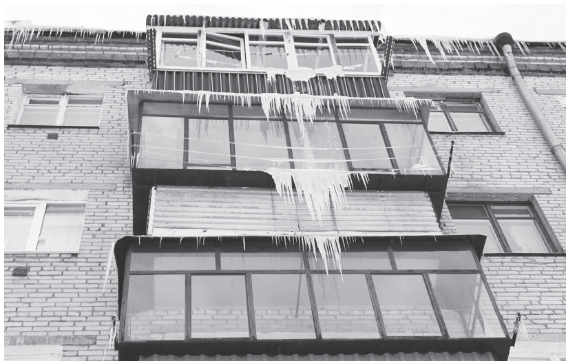
После обильного снегопада вперемешку с каплями дождя кровли и балконы многоквартирных домов оказались сплошь увешаны громадными сосульками, образовав ледяные stalactites
