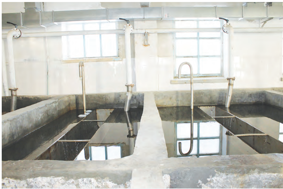
Зал фильтрации на насосно-фильтровальной станции города Касли
