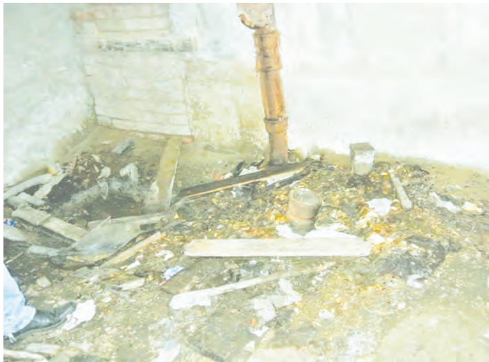
Удручающее впечатление производит состояние подвала в доме №97 по улице Стадионной. Фото жителей
